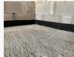
Figura 2 – Rodapé de polietileno expandido autocolante (FitaPiso) fixado na base da alvenaria como junta de dessolidarização do contrapiso com argamassa colante
